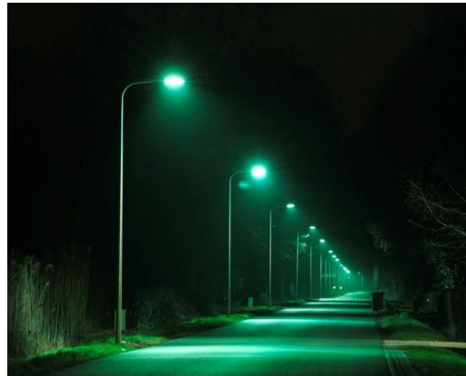
Figuur 7.32: LED-verlichting, foto tctubantia.nl
