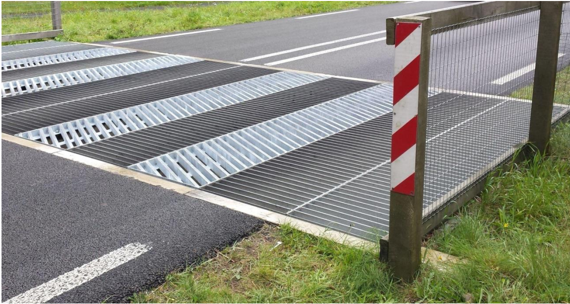
Foto 4: wildrooster dwars op de weg. De installatie van dergelijke roosters aan de rand van de oversteekplaatsen kan vermijden dat overstekende dieren niet rechtlijnig oversteken en zich langer in het verkeer zouden begeven door de aanwezigheid van de ecorasters buiten de oversteekplaatsen. ©mp.nl
